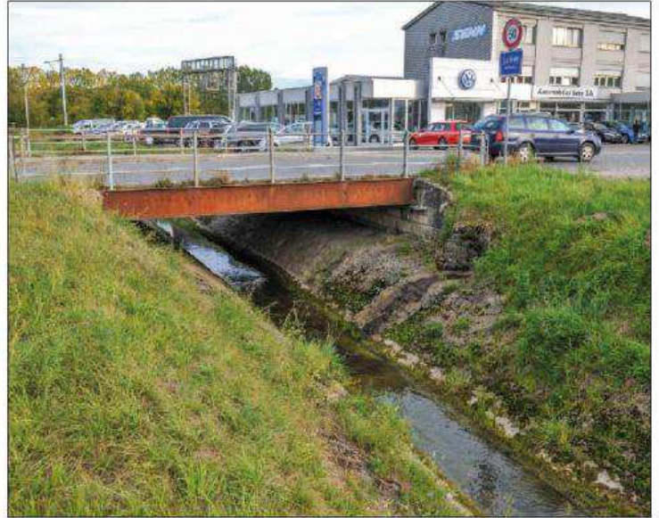
A la hauteur de la route cantonale, le lit du cours d'eau est particulièrement étroit et mal adapté à l'évolution des crues.
